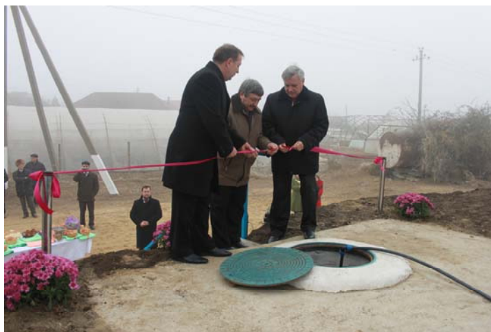
Lansarea apeductului în satul Colibași, raionul Cahul – proiect finanțat de Fondul Ecologic Național în sumă de 2,41 milioane lei.
